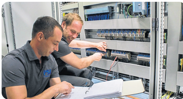
Inbetriebnahme eines Schaltschranks durch das Ingenieurbüros Dohm PSI. (Foto: Lea-Marie Dohm)
